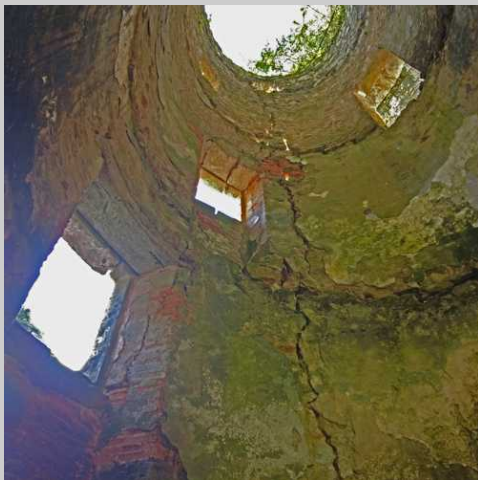
Traces des marches d'escaliers ainsi que d'incendie
